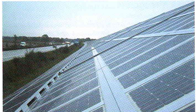
Bild 1. Freising-Lerchenfeld – die weltweit größte kombinierte Photovoltaik-Schallschutzwand
